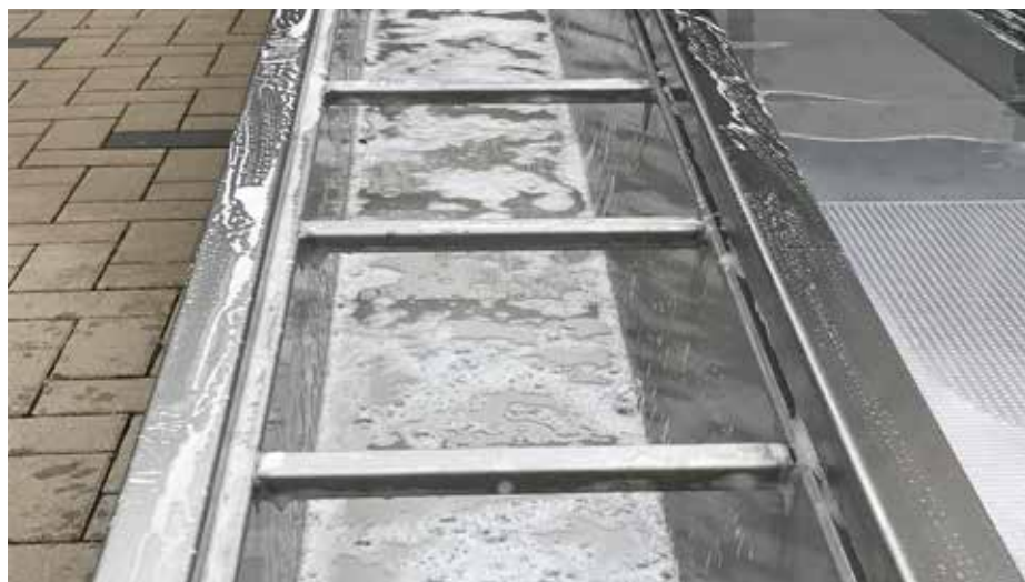
Abbildung 20: Überlaufrinne im Schwimmbadbau
